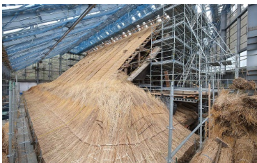
<建造物解体修理の様子> 重要文化財 天徳寺本堂ほか2棟 (秋田県)
