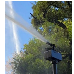
(放水銃) 近隣火災から護るための 放水銃、ドレンチャー 等
