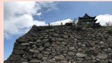
孕み出しが進み崩落の危険があった石垣
