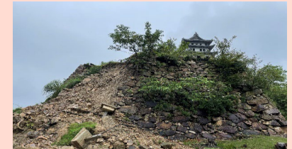
整備が遅れて石垣が崩落
