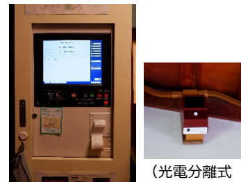
(R型受信機) (光電分離式煙感知器) 高機能な自動火災報知施設を設置し、迅速に初期消火へ
