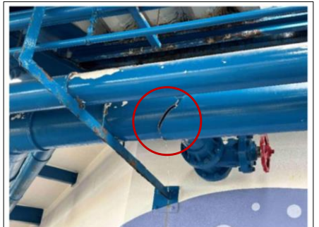
イルカプール循環配管破断箇所
