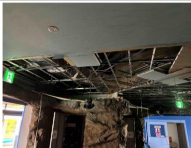
本館1階観覧通路天井崩落
