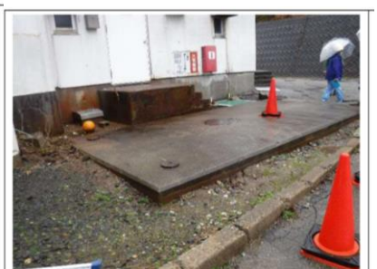
重油タンク周囲の沈下
