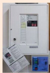
自動火災報知設備（受信機）
