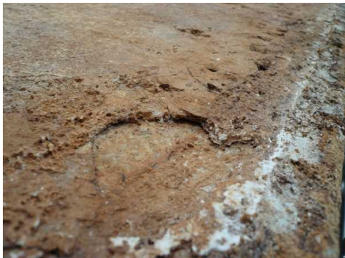
写真 19 漆喰小口の浮き上がりの状況
