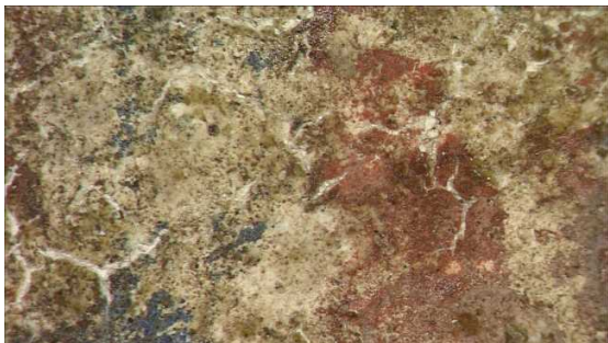
写真 18 乾燥すると亀裂が再び生じる
