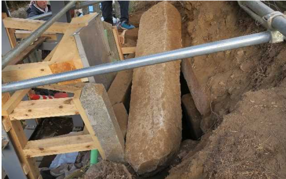
前庭部天井石崩落状況
