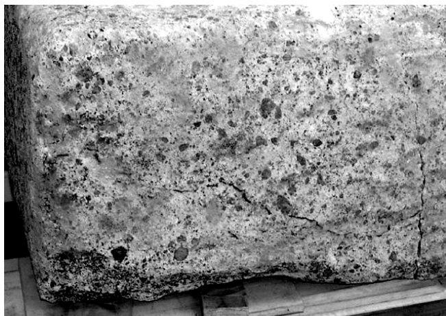
図 1.6. 床石 4 の西側面に発生している亀裂
