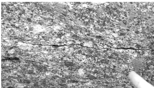
図 1.5. 床石 4 の底面に発生している亀裂
