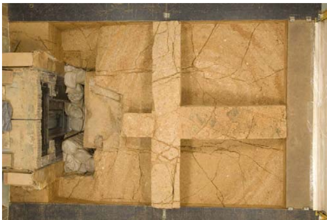
3 石室直上の亀裂
