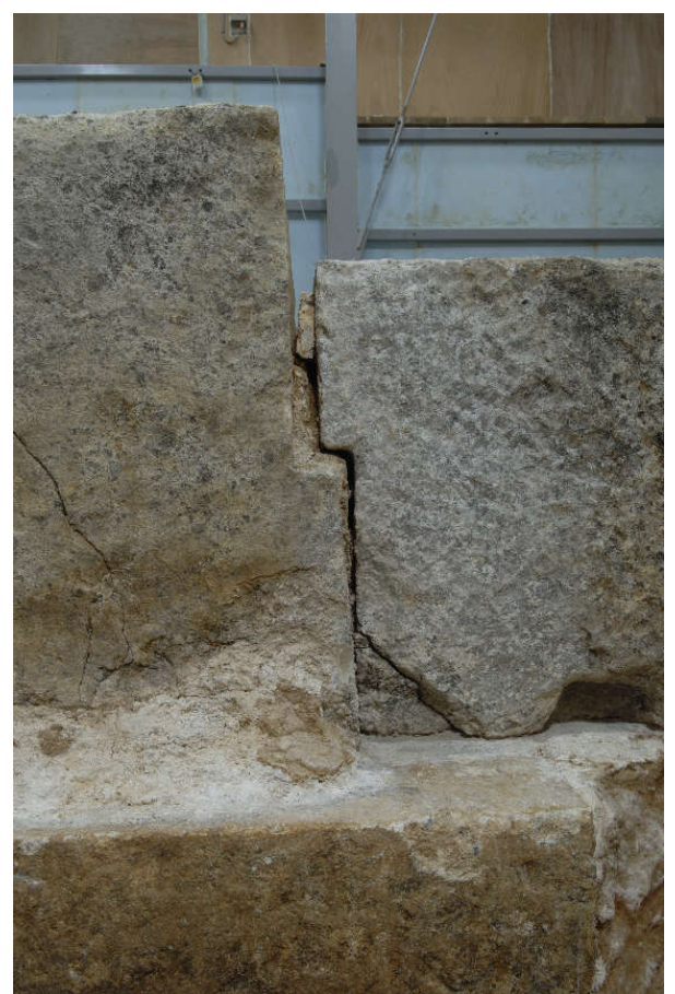
4 同上東側面漆喰除去後の状況
