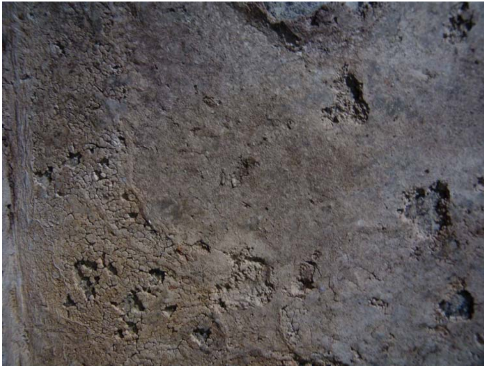
写真 2－1 剥離箇所の一例
