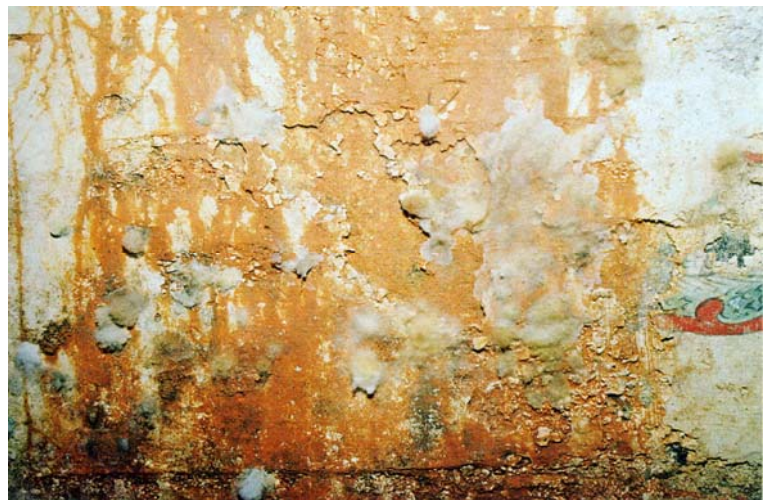
写真 1-2 青龍のカビ発生状況 (平成 13 年 12 月)
