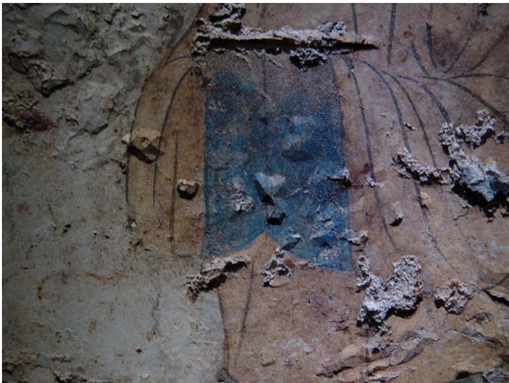
写真 2－6 漆喰層内部が中空化し、陥没。また樹脂処置部分が濡れ色となっている（青色彩色部分から黄色彩色部分）。さらに、その樹脂の白濁化も見られる（画面右上方）
