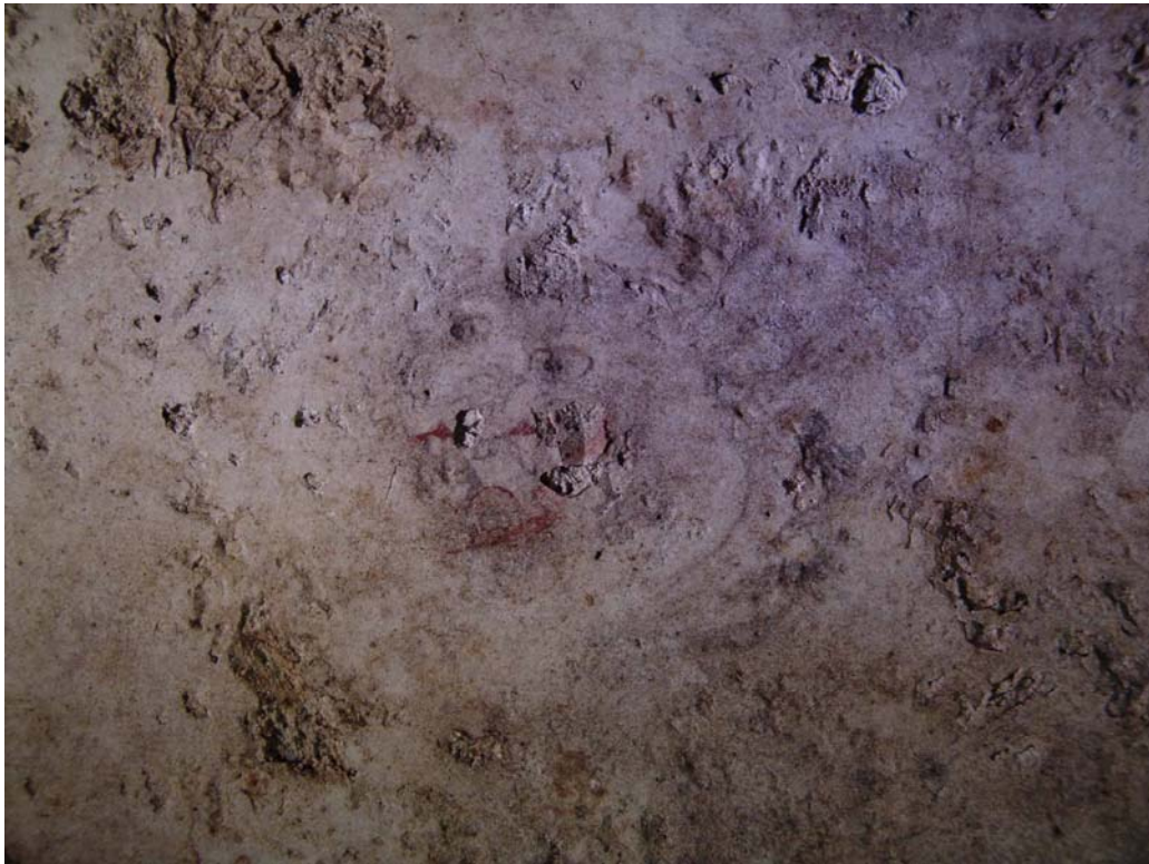
写真 2－5 漆喰層内部が中空化し、陥没
