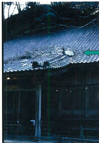
裏山の崖の凍結 破壊による落石
