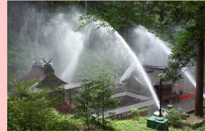
「消火設備（放水銃）の設置」
