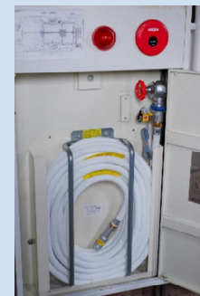
一人で操作できる屋内消火栓
