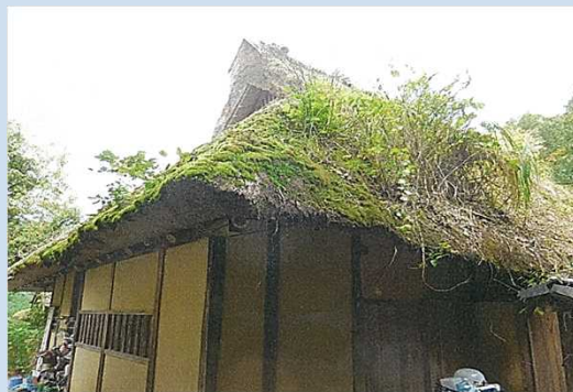
修理前（南東から）
