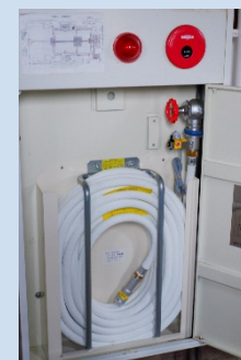
一人で操作できる屋内消火栓
