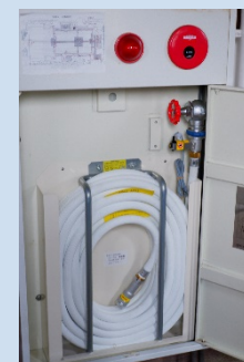
一人で操作できる屋内消火栓
