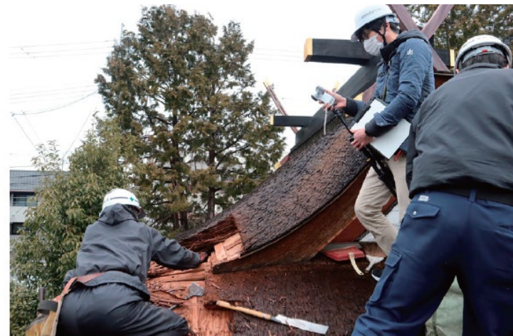
崇道天皇社（奈良県奈良市）檜皮葺屋根焼損箇所での現地調査（文化財防災センター）
