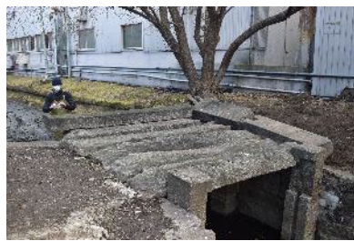
笠石が破損した樋門
