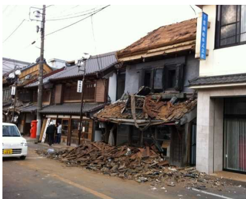
写真 26 地震時の屋根瓦脱落 （香取市佐原地区）
