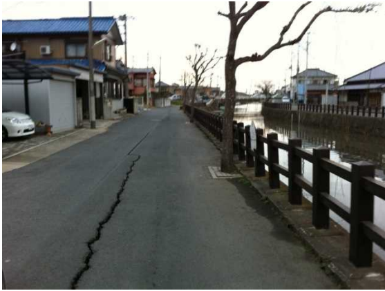
写真 28 地震時の地盤変状 (香取市佐原地区)
