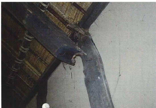
写真 11 仕口部の破損（柱梁接合部）
