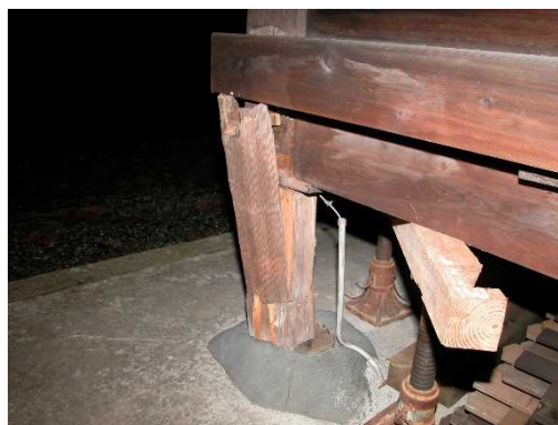
写真 12 柱足下の破損
