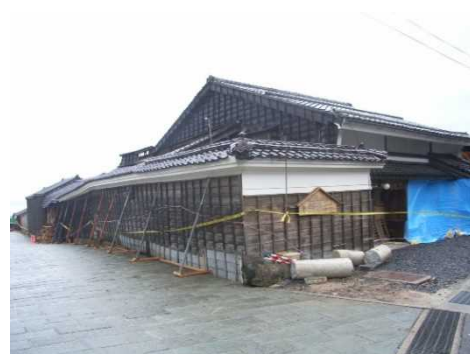
写真2 能登半島地震平成19年(2007年) 輪島市黒島地区伝統的建造物群保存地区(地震発生時伝建地区決定前)では、建造物が傾斜する等の被害が生じた。
