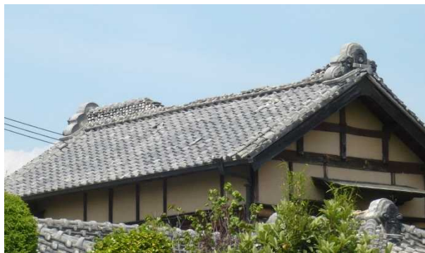
写真 10 屋根瓦の脱落・大棟棟積の破損
