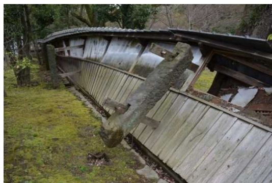
写真 35 地震による塀の倒壊（旧細川刑部邸）
