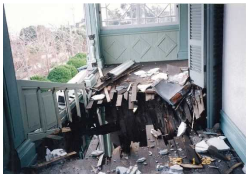
写真1 阪神・淡路大震災 平成7年(1995年) 神戸市北野町山本通伝統的建造物群保存地区では、洋館に大きな被害が生じた。写真は煉瓦煙突が地震により折損脱落し、床を突き破ったもの。
