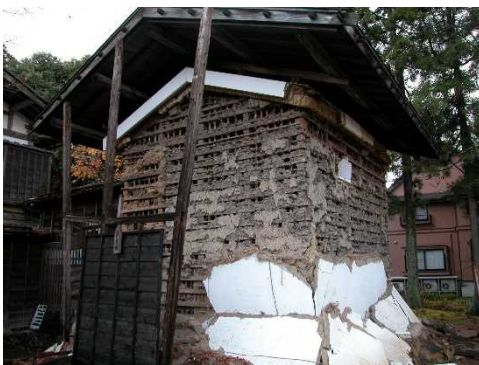
写真 9 土壁の崩落（土蔵）
