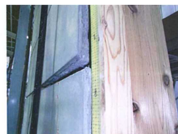
モルタルのはらみ出し（瓦モルタル 1P-3）
