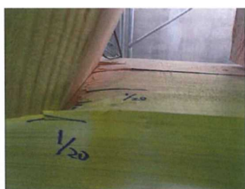
土台のめり込み（筋かい-2）
