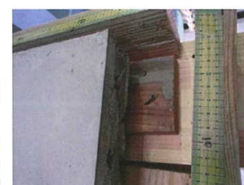
釘のせん断破壊（瓦モルタル 2P-3）
