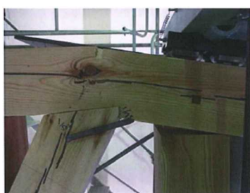
桁折損（筋かい-1）
