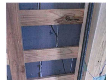
瓦下地ひび割れ（瓦モルタル 2P-1）
