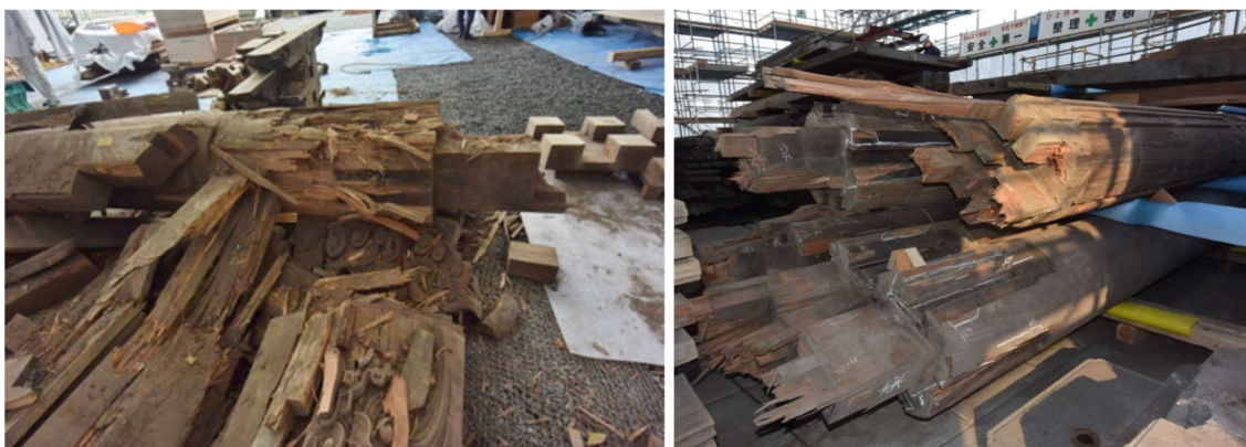
写真1 柱頭部分の破損状況
