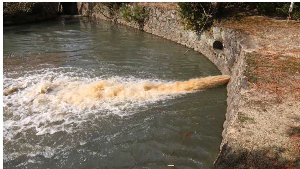
消火栓の制水弁の開放
