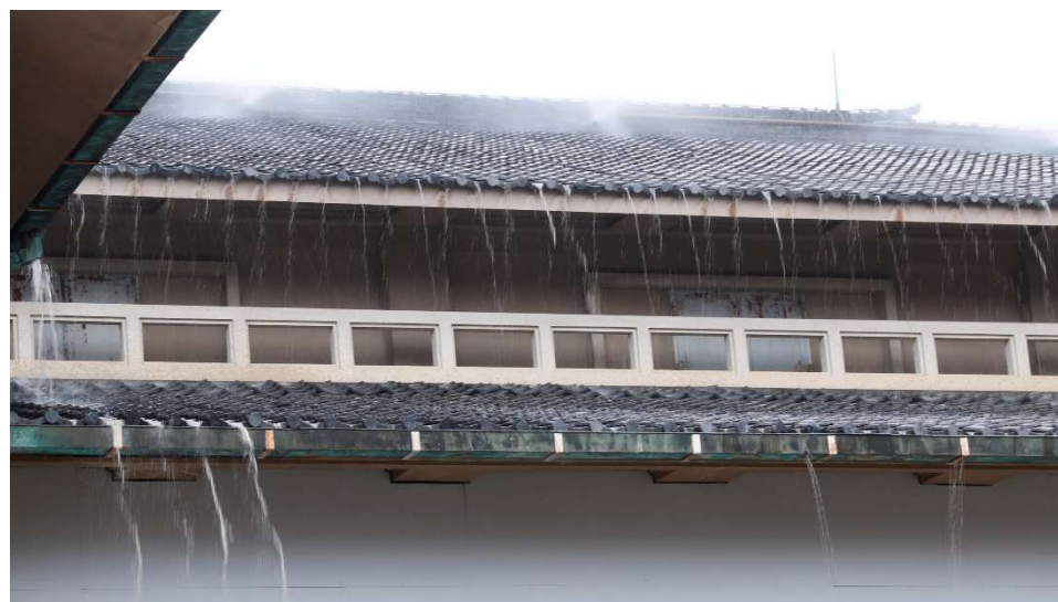
ドレンチャー放水
