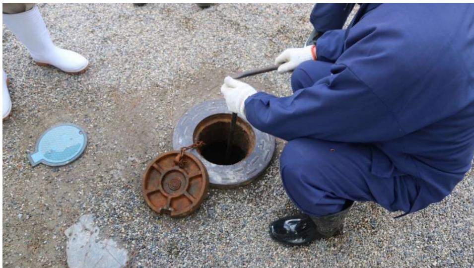
消火栓の制水弁の開放
