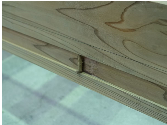
敷居のめり込み (M 試験体)
