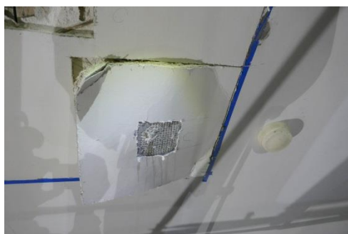
試験体 C2-1 (剥落後)
