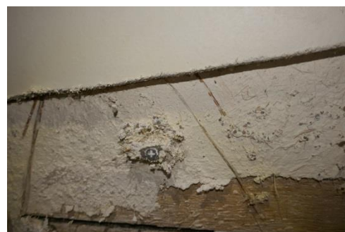
試験体 C2-1 (剥落後ビスの様子)
