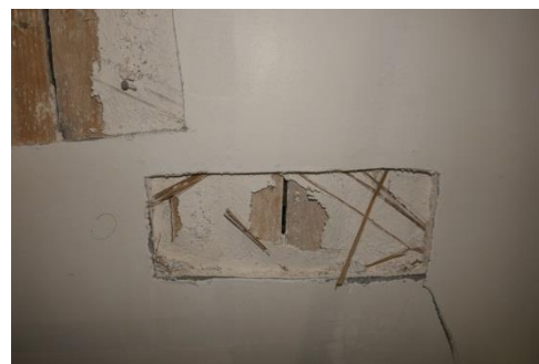
試験体 C1-2 (剥落後)
