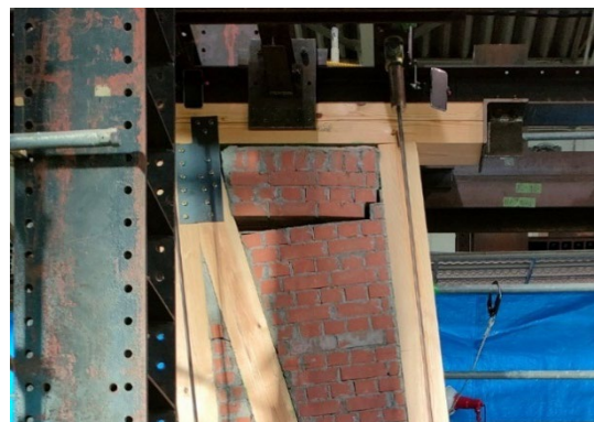
2-BV2 試験体 頂部 煉瓦離間状況
