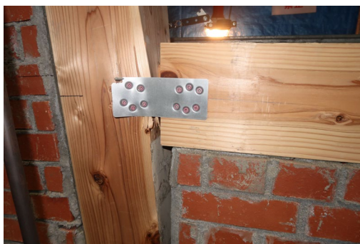
2-WBV 試験体 窓台端部破壊状況
