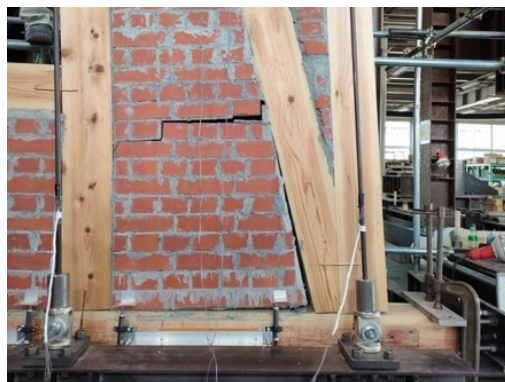
1-WBV 試験体 脚部ひび割れ状況
