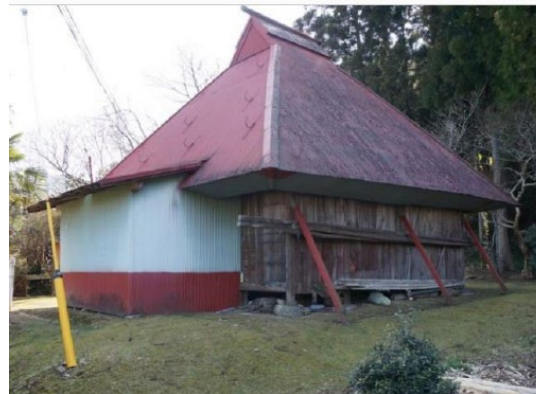
修理前。老朽化が進み、傾倒が進行
