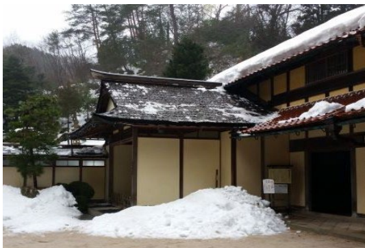
雨漏りが始まった絲原家住宅柿葺き屋根
