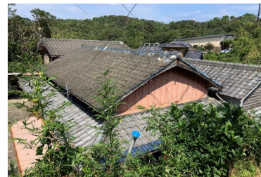
修景前。 瓦や壁面が老朽化
