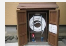
まちなみ消火栓
