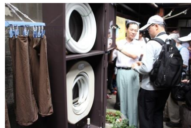
屋外易操作消火栓
