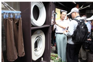
屋外易操作消火栓
