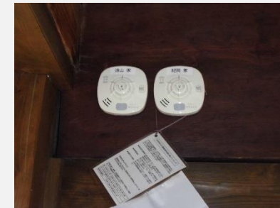
自動火災報知器
