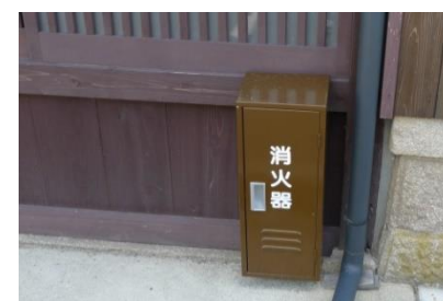
まちかど消火器
