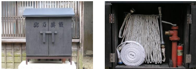
消火栓・ホース収納箱
