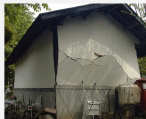
宮城県沖地震の被害
