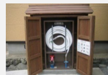
まちなみ消火栓
