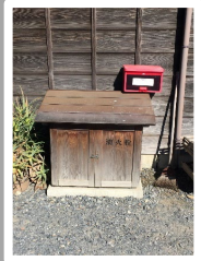
初期消火用 消火栓の整備
