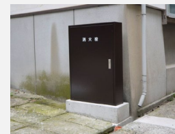
消火栓(温泉津地区)
