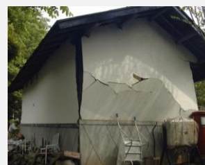
宮城県沖地震の被害
