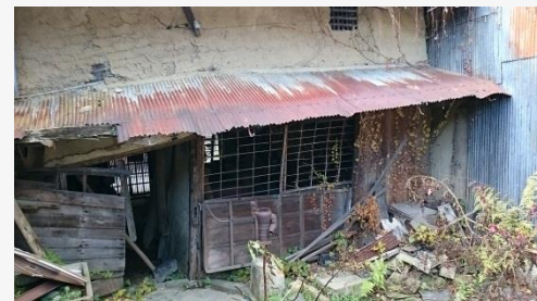
建物破損状況
