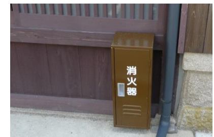
まちかど消火器
