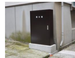
消火栓(温泉津地区)
