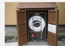
まちなみ消火栓
