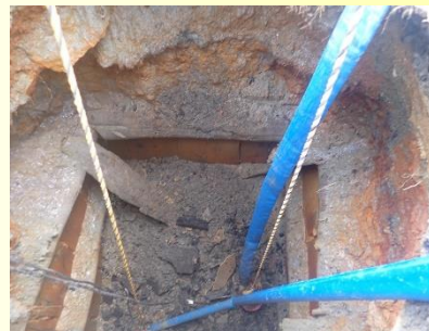
(陷没箇所内部)
