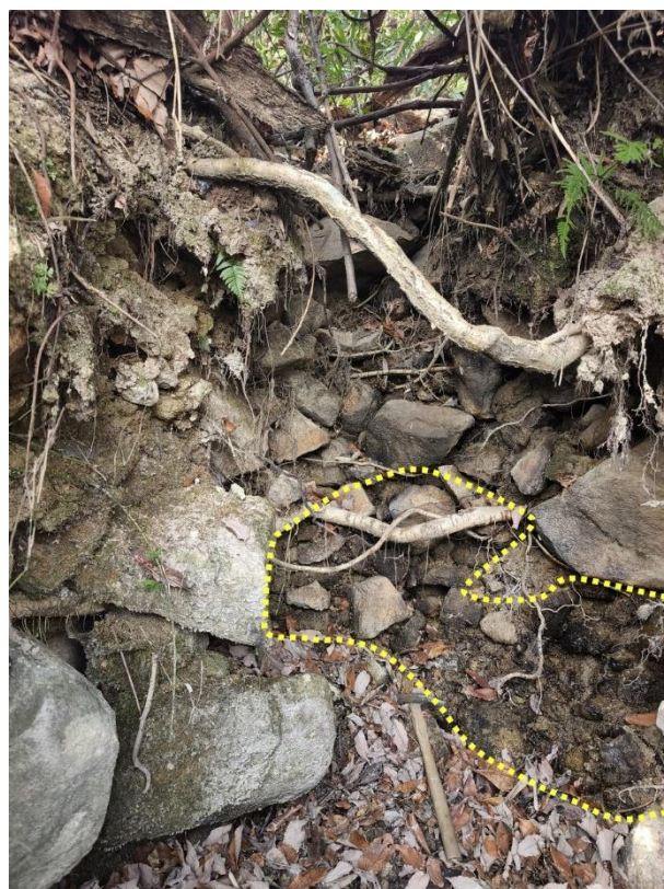
図2-60 崩積土堆積面の鉛直断面を示す露頭（侵食谷の谷上端部）黄色破線内に湧水による濡れが認められる。なお、観察時は晴天であった。
