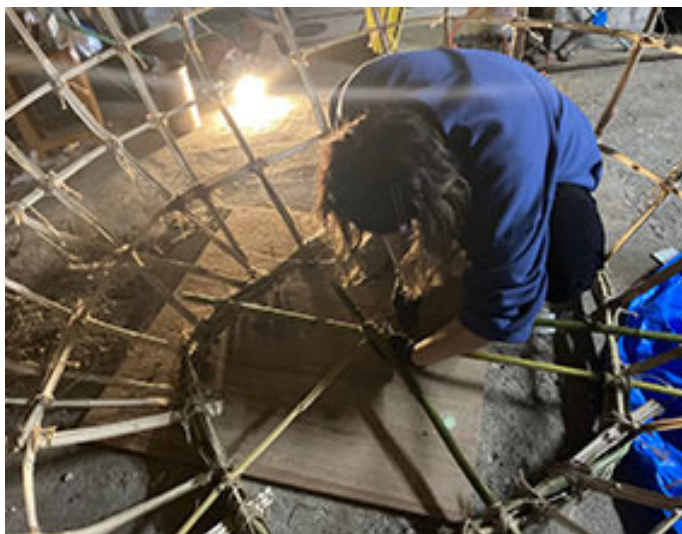
▲モニュメントの基礎制作は危険を考慮し貸しガレージで行った
